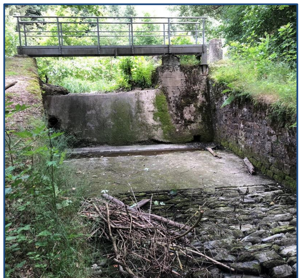
Nicht funktionstüchtiger Teil des Überfallwehres und Bediensteg (Quelle: KUBENS Ingenieurgesellschaft mbH)
