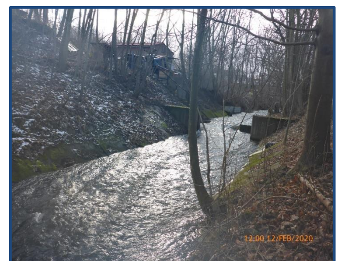
Abbildung OH 7, km 3,37, HKW Stahlverformung, Reste Querbauwerk, Gewässerbefestigung Länge ca. 60 m (Quelle: ThLG)
