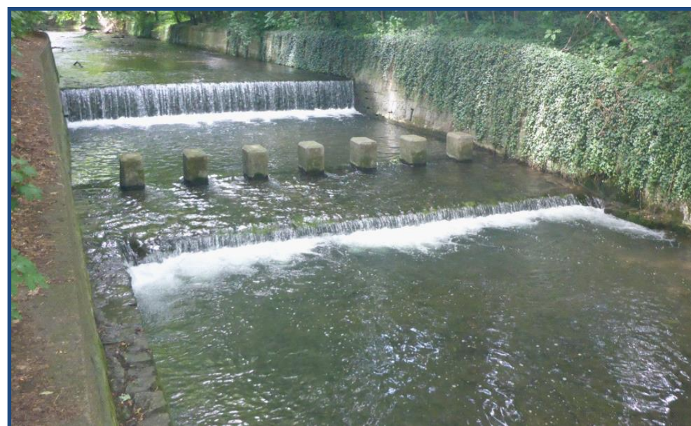
Absturz „Ehem. Brauerei (Wollmarkt)“, Absturzhöhe ca. 1,20 m
