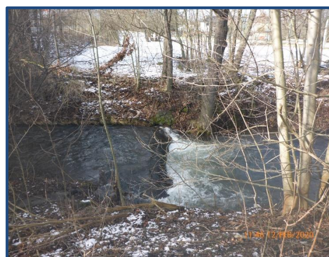
Abbildung OH 6, km 3,18, Brücke Halbmondsweg, Schwelle unterhalb (Quelle: ThLG)
