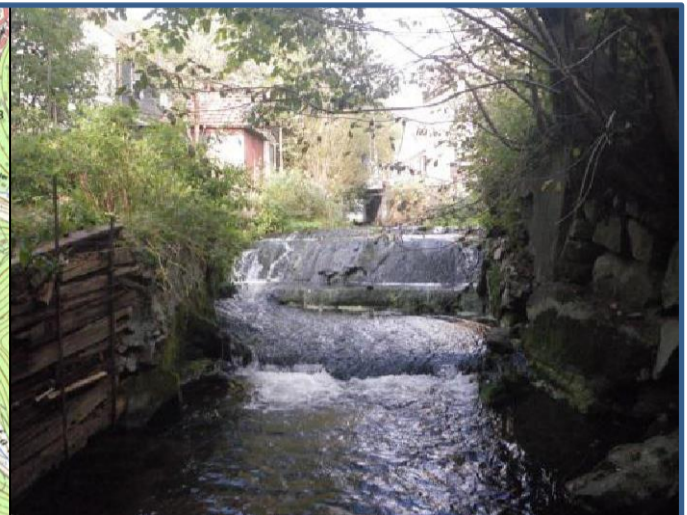
Die zweistufige Wehrschwelle LA 35 unterbricht die ökologische Durchgängigkeit
